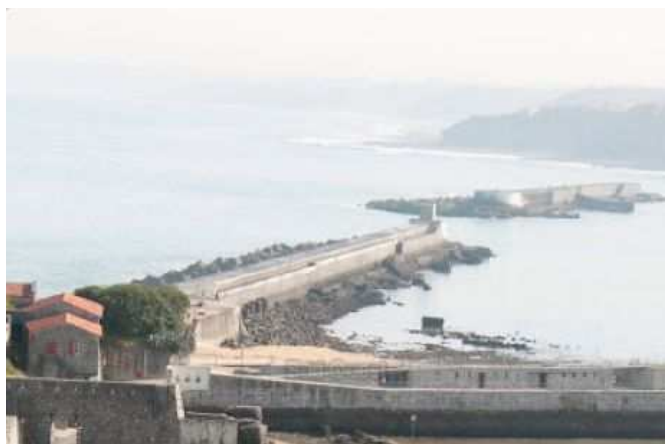
Une étude sur l'état des digues est lancée. PHOTO P. S.
